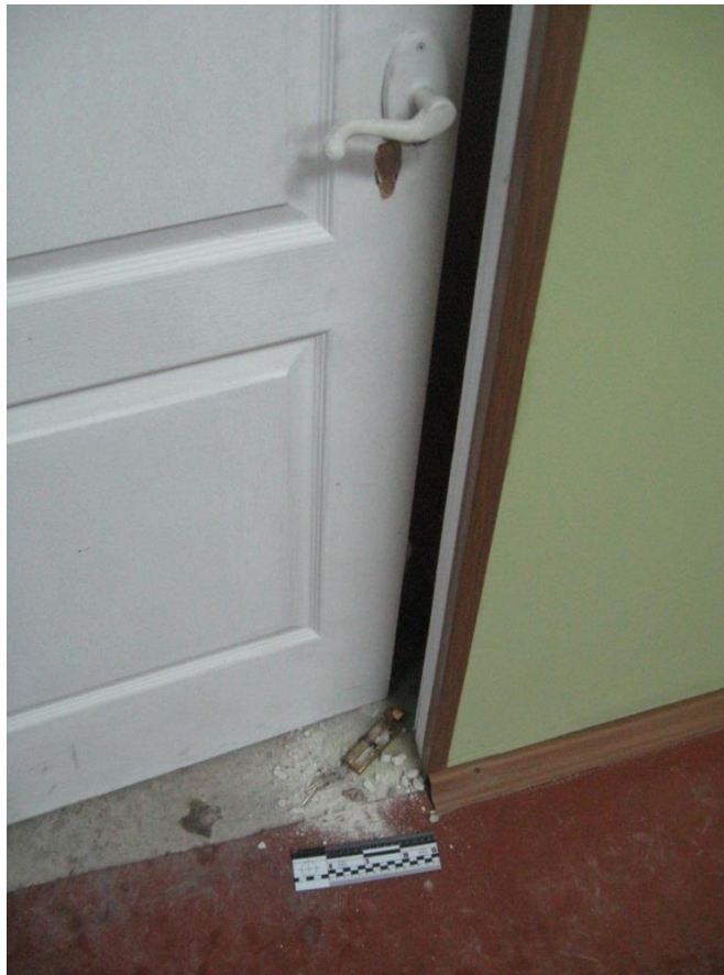
Фото № 9 Зовнішній вигляд дверей з ознаками злому.
